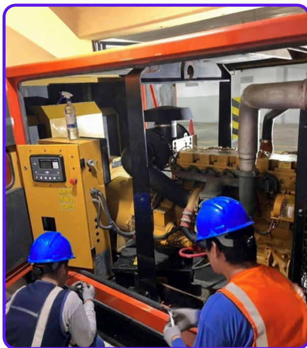
Mantenimiento de Grupos Electrógenos
