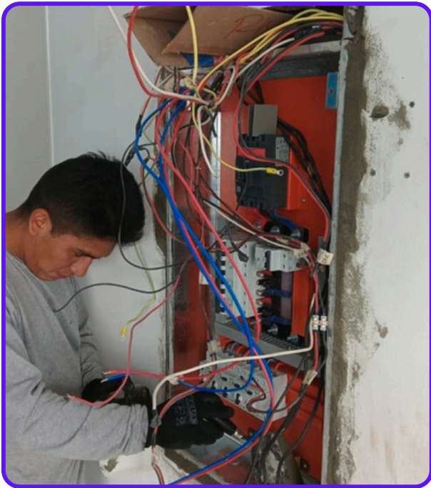
Instalaciones de Tableros Eléctricos
