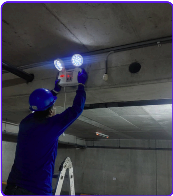
Mantenimiento de Luces de Emergencia
