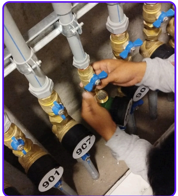
Mantenimiento de Contómetros
