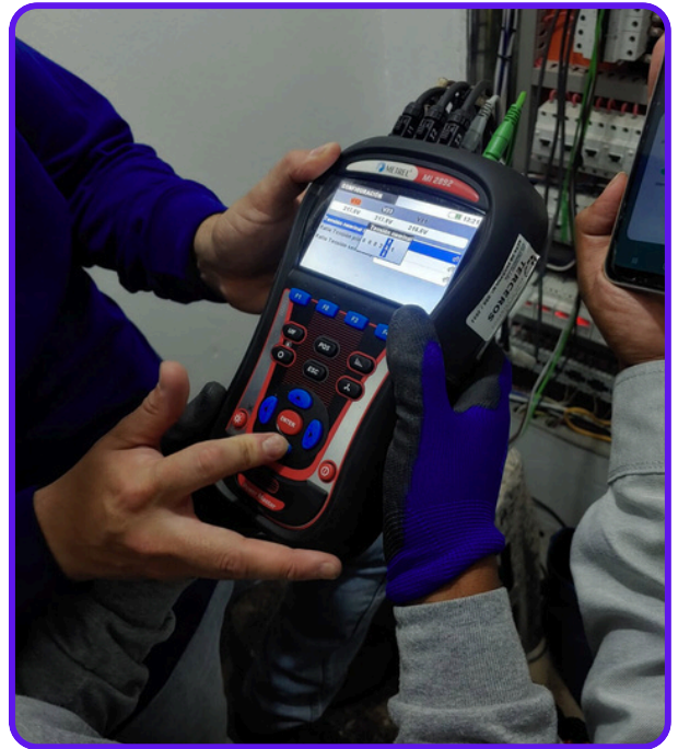
Revisión/Instalación de Energía Reactiva Capacitiva
