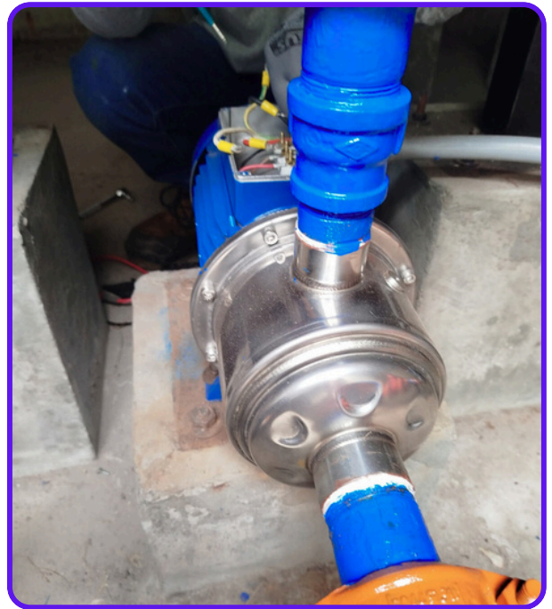
Mantenimiento Preventivo de Bombas
