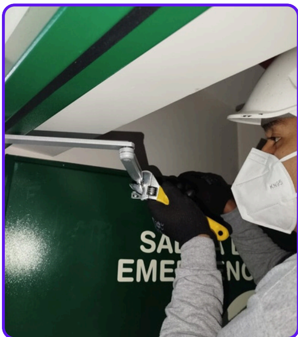
Mantenimiento de Puertas Contra Fuego
