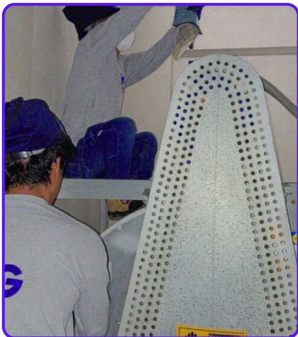
Mantenimiento de Sistemas de Extracción de Monóxido
