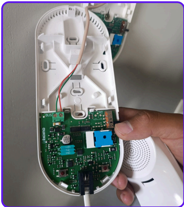
Mantenimiento Preventivo de Intercomunicadores
