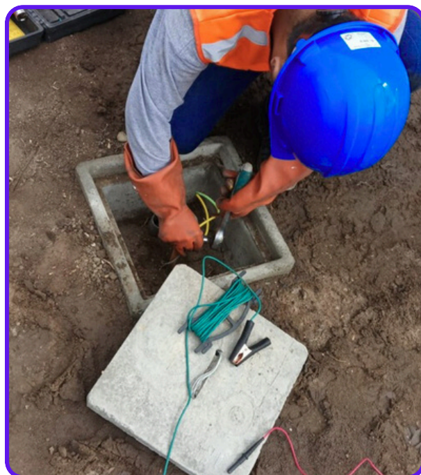
Mantenimiento de Sistemas de Pozos a Tierra
